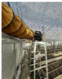
外気導入 ダクトファン
